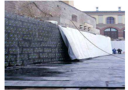
Außenwandaufbau des Archivkellers: Wärmedämmung (dunkel) auf Betonausgleichsschicht vor Bohrpfahlwand, diffusionsdichte Folie (weiß), WU-Betonwand (noch nicht hergestellt)
