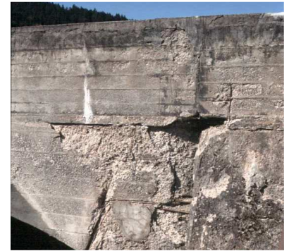
Schadensdetail an der Mauerkrone
