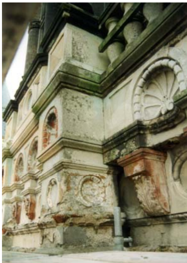
Schäden: Balustrade, Terrakotten und Putz
