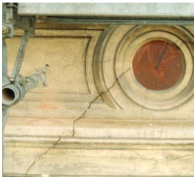
Riss in Fensterbrüstung mit Steinzeugplatte
