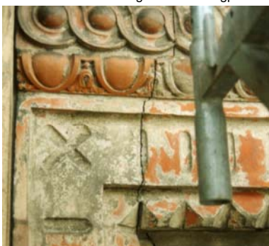
Riss in Fenstersturz mit Terrakotta
