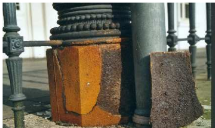
Abgeplatzte Gussteile an einem Säulenfuß
