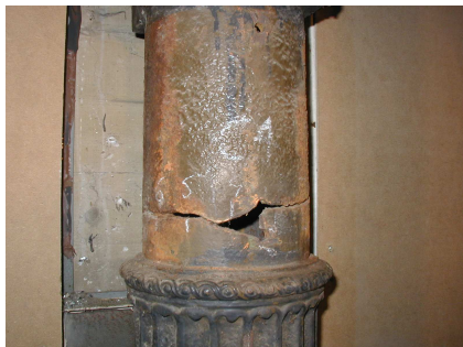
Unter den Stahlmanschetten zeigten einige Säulen schwere Schäden
