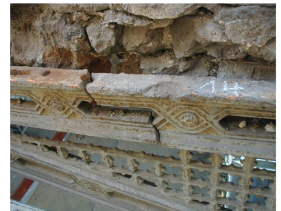
Die Bogenträger weisen Schäden infolge Setzungsdifferenzen auf
