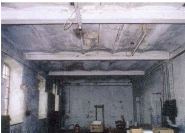
EG vor der Instandsetzung
