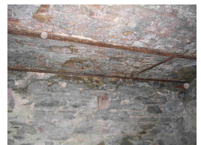
Ziegelgewölbedecken und korrodierte Stahlträger im Tunnelportal Alter Rossteintunnel
