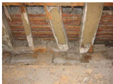
Schäden Mansarddach WG
