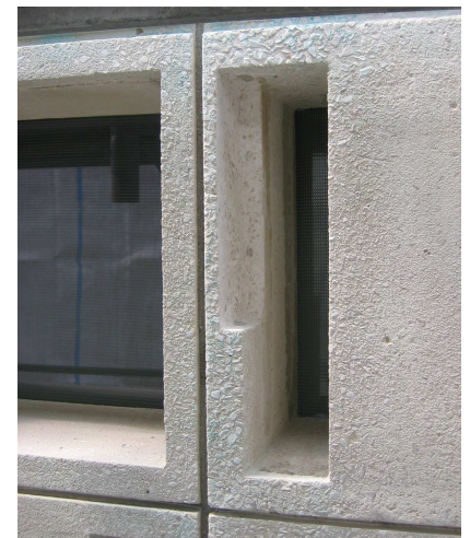
Vierungsartig ausgearbeitete Schadstelle in einer Betonsteinwabe
