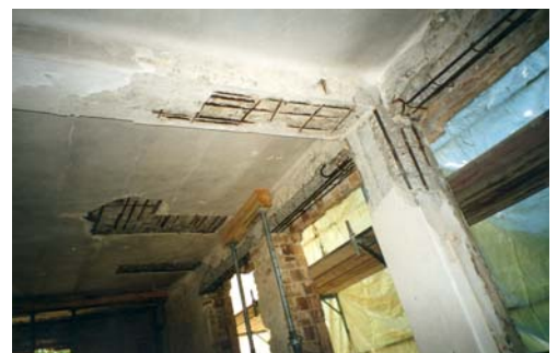
Betonschäden an der Tragkonstruktion
