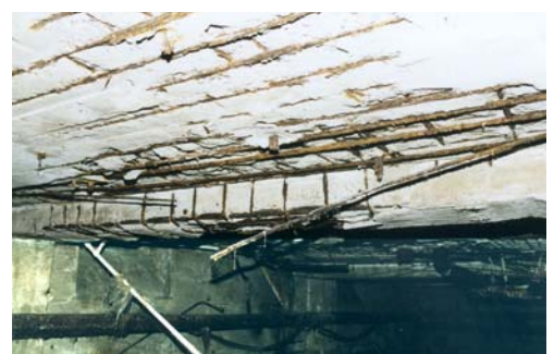
Erheblich geschädigte Kellerdecken
