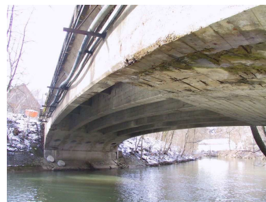
Betonschäden an der Unterseite der Brücke infolge schadhafter Abdichtung
