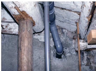
Deckenabsenkung wegen durchtrenntem Streichbalken für Einbau Abwasserleitung
