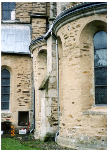
Verformte Umfassungswand des Kapellenkranzes
