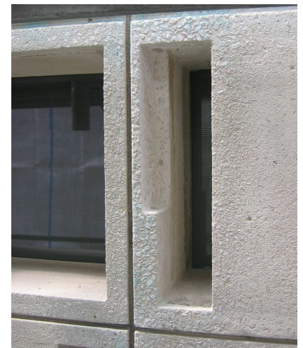
Vierungsartig gearbeitete Schadstelle in einer Betonsteinwabe
